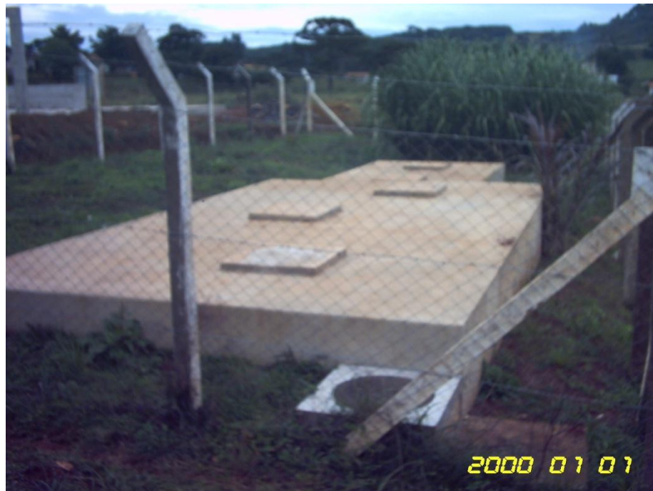
Foto 04 Detalhe em primeiro plano da fossa, seguido do filtro e ao fundo o sistema de raízes em pleno funcionamento no Bairro Dom Daniel em São José do Cerrito - SC em 2002. Primeiro sistema de tratamento de esgoto aprovado e implementado pela FUNASA no Brasil
